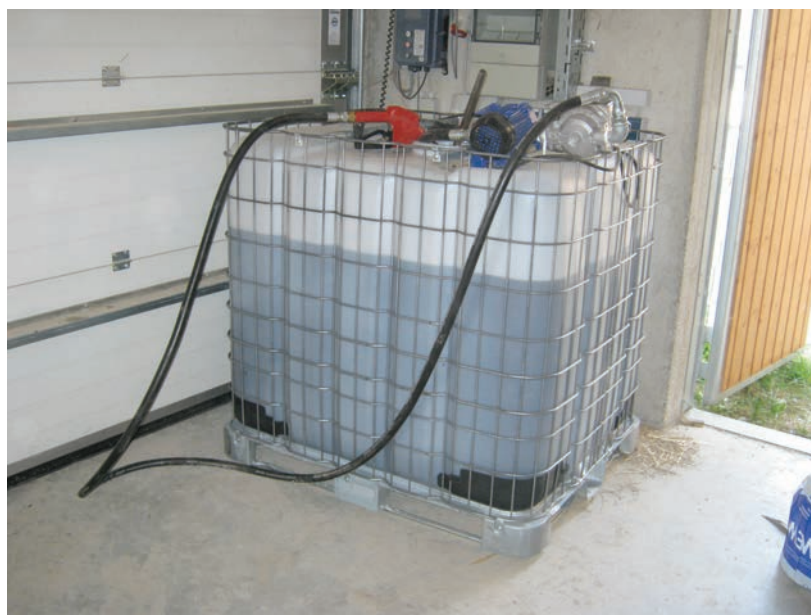
Abbildung 5: Biodiesel-Zapfanlage (1000 Liter IBC), Josef Koller – Gersthofen
