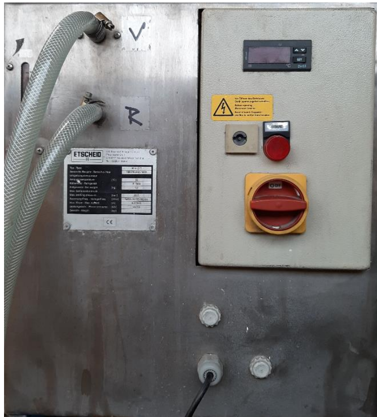
Abbildung 44: Durchlaufkühler zur Kraftstoffkühlung
