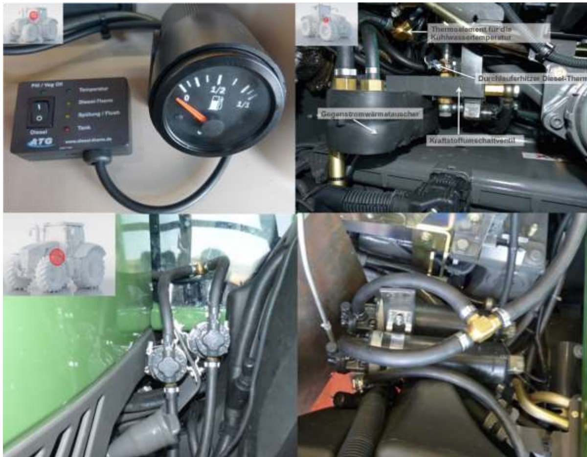
Abbildung 7: Kraftstoffumschaltung mit Füllanzeige für den Dieseltank (links oben), Umschalteinheit mit Gegenstromwärmetauscher (rechts oben) und zusätzliche Zahnradpumpen für Pflanzenölkraftstoff (links und rechts unten)
