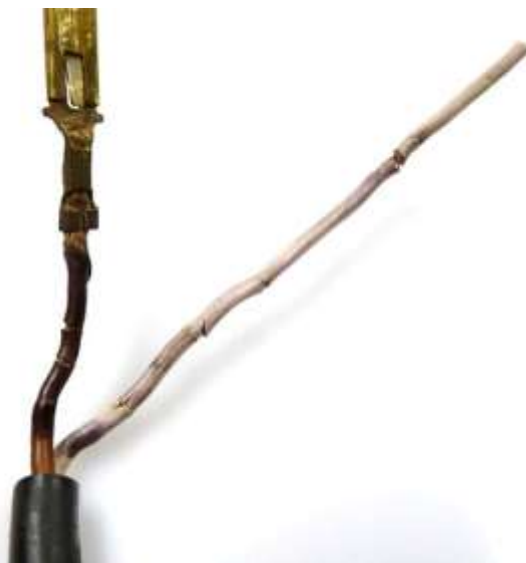
Abbildung 34: Defekte Verkabelung an der Förderpumpe des Niederdruckkraftstoffsystems des Traktors JD-K
