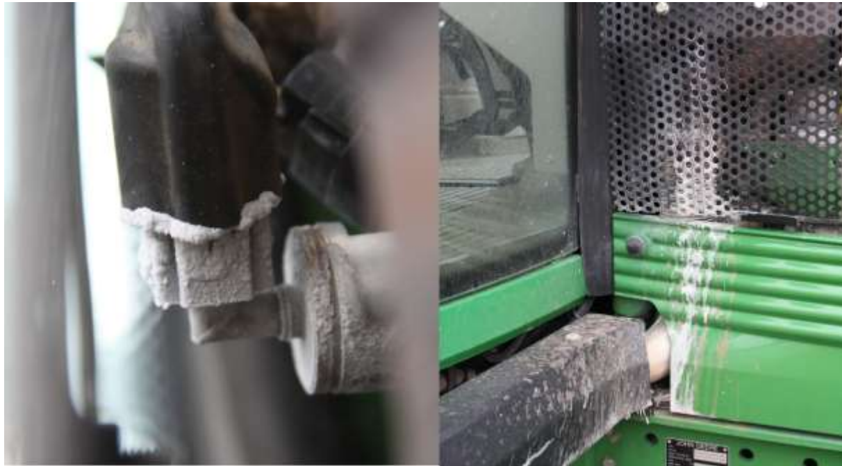
Abbildung 33: Ablagerungen infolge ausgetretener wässriger Harnstofflösung an der AdBlue®-Leitung (links) und an der Außenseite der Abgasnachbehandlung (rechts) des JD-K
