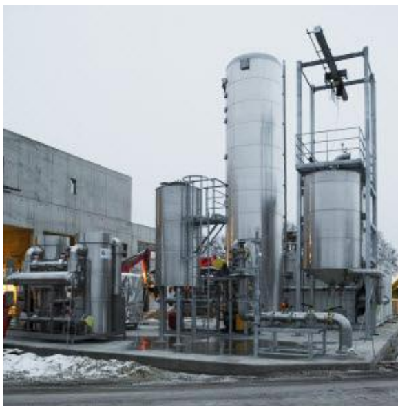
Abbildung 29: Methanisierungsanlage in Werlte, Niedersachsen (Bild: Audi AG in [MAN 2013])
